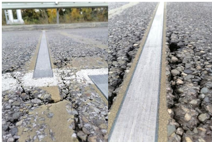
Рис. 3. Дефекты проезжей части в зоне весоизмерительных датчиков Fig. 3. Defects of the road pavement nearby weighing sensors
