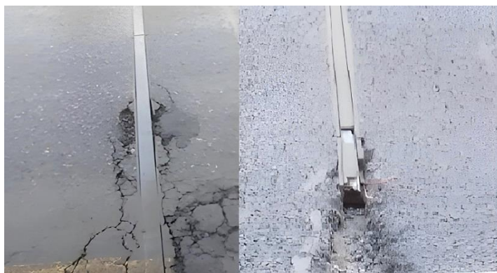
Рис. 4. Разрушение покрытия и весоизмерительного датчика Fig. 4. Pavement and weighing sensor destruction
