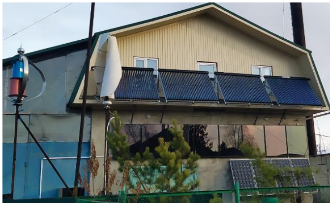
Рис. 1. Внешнее оборудование гибридной солнечной системы ГВС, построенной в цехе № 1 «НПО ВЭСТ» в с. Кафтанчиково Томской области
