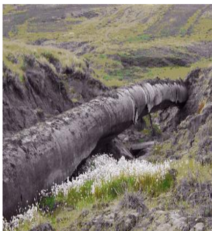
Рис. 1. Образование плавающего участка (а) и арки выброса (б) на линейной части действующего магистрального трубопровода
