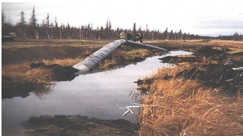
Рис. 3. Выход на поверхность незабалластированного участка магистрального нефтепровода с образованием арки на заболоченном участке трассы
