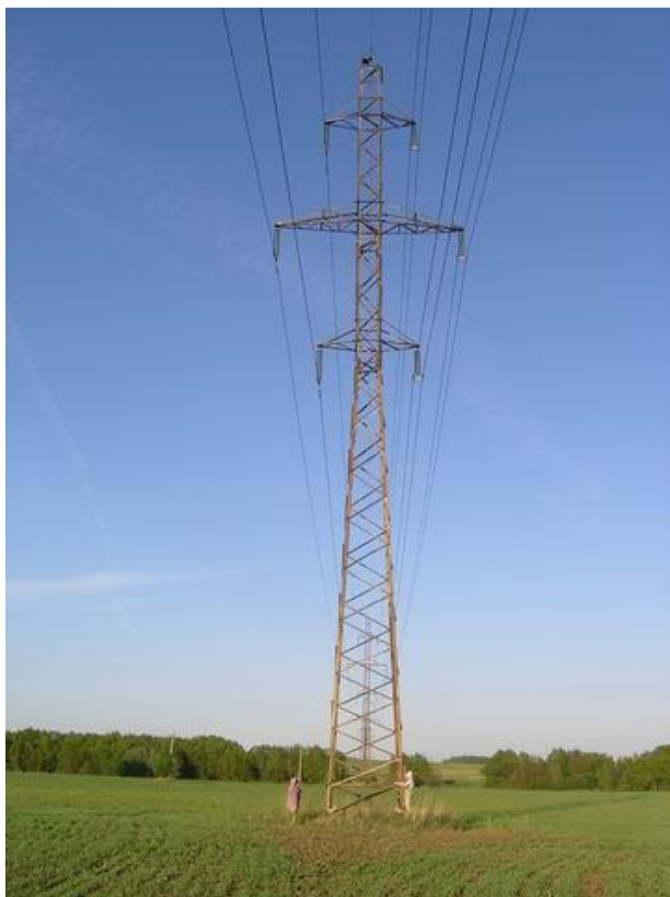
Рис. 1. Опора ВЛ 110 кВ «Тойма 2 – Прикамская»
