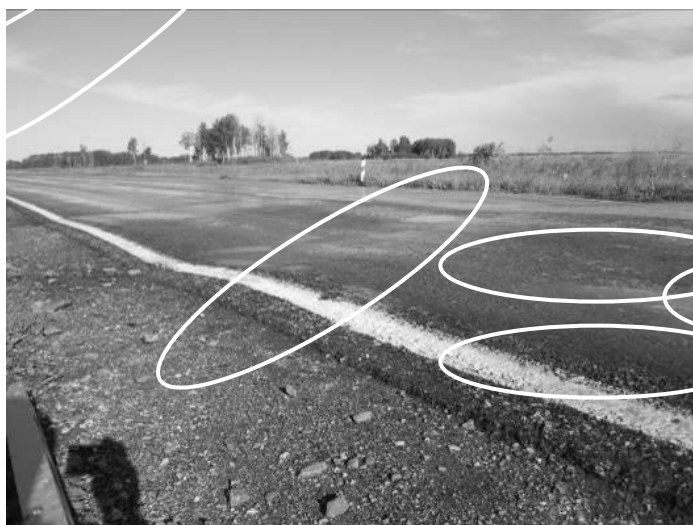
Рис. 1. Деформации покрытия в виде просадки в местах устройства водопрпускных труб
