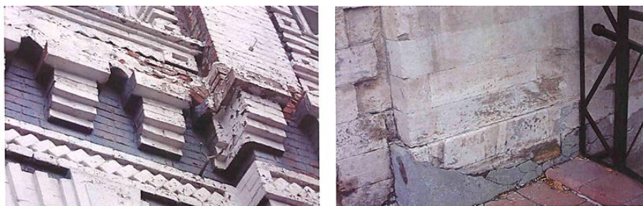
Рис. 4. Результаты визуального осмотра с выявлением дефектов наружной кладки усадьбы городского купца П.И. Серякова 5
