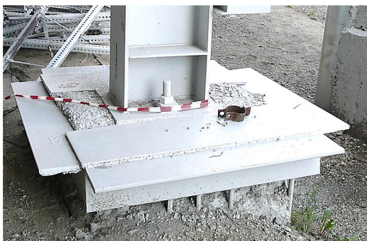
Рис. 2. Бетон пористой структуры в контурной области металлической плиты базы колонны Fig. 2. Cellular concrete in the perimeter of the base metal plate.
