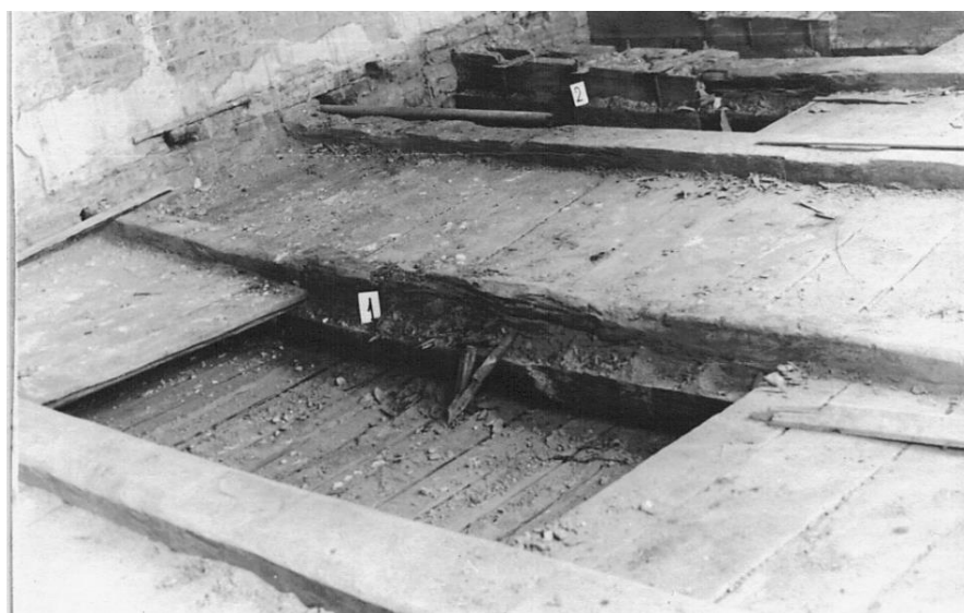
Рис. 13. Деструкция балок перекрытия в их средней части. ТГУ. Фото из архива СИ «Сибспецпроектреставрация», 1987 г., автор В.А. Кондратьев
