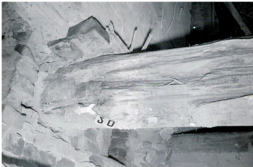
Рис. 12. Деструкция балок перекрытия в местах опоры. ТГУ. Фото из архива СИ «Сибспецпроектреставрация», 1987 г., автор В.А. Кондратьев
