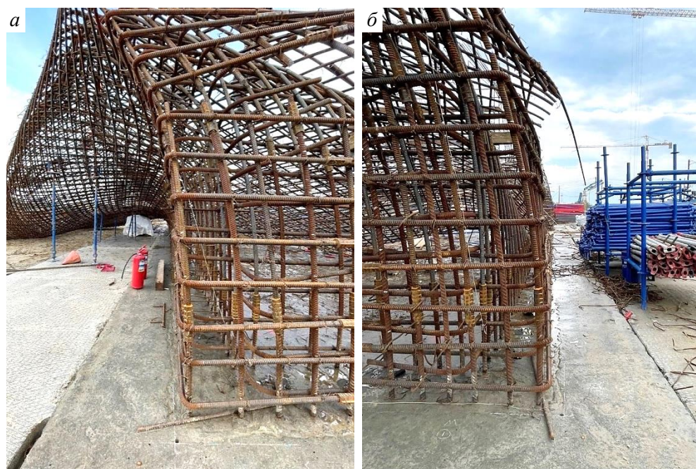
Рис. 1. Общий вид деформации арматурного каркаса:
