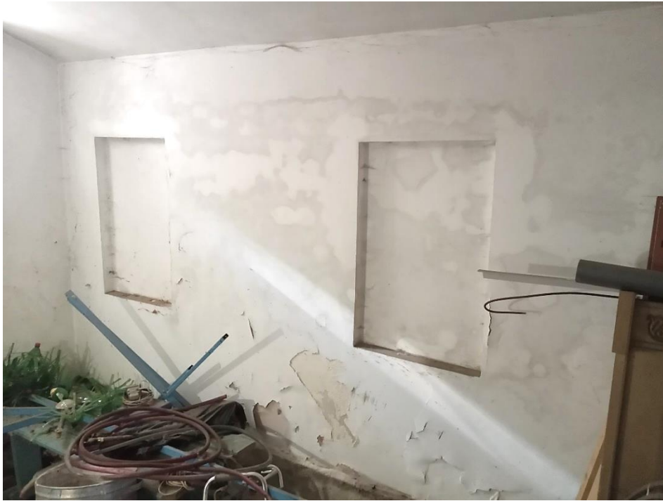
Рис. 8. Состояние стен церкви Петра и Павла. Фото А. Кутукова, сентябрь 2022 г. Fig. 8. Walls of the Peter and Paul Church, September 2022. Photograph by A. Kutukov
