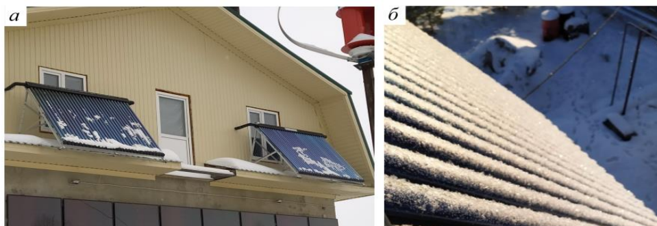
Рис. 2. Внешние части солнечной водонагревательной установки после снегопада: а – отложения снега на коллекторах (04.04.2021); б – заледневшие поверхности труб коллекторов (12.01.2021)
