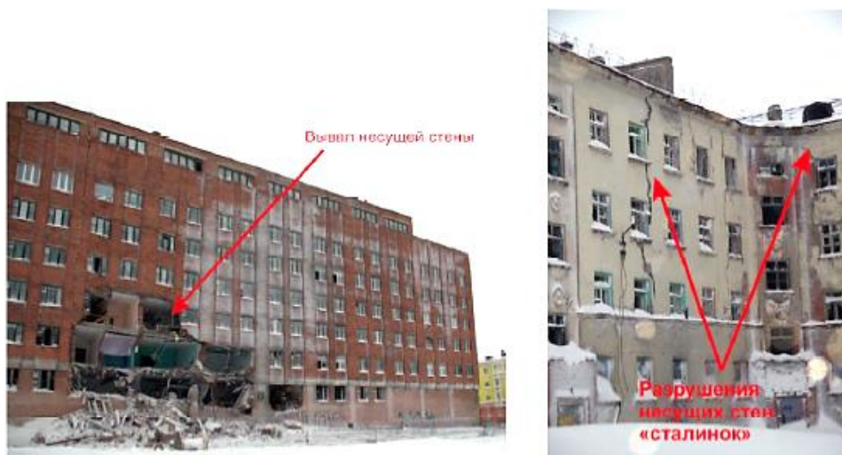
Рис. 1. Разрушение административного здания (слева) и жилого здания (справа) в г. Норильске
