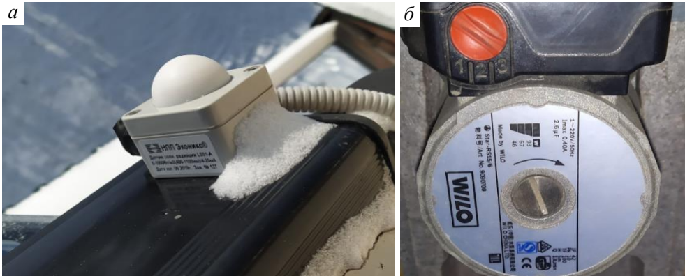
Рис. 2. Элементы СВНУ: а – датчик солнечной инсоляции; б – циркуляционный насос
